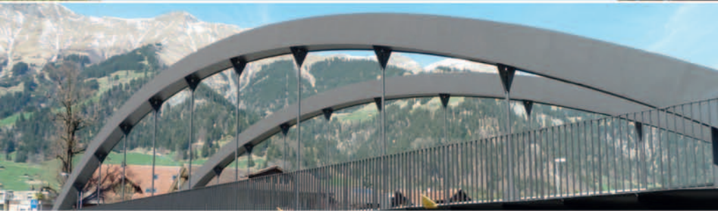
Widibrücke à Frutigen, BE: Planification et suivi des travaux de protection anticorrosion
