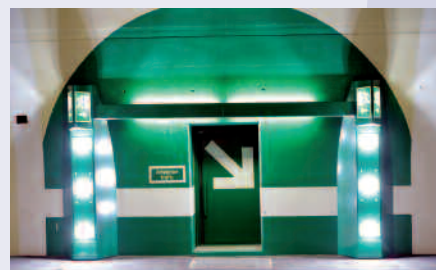
La Tranchée couverte de la Beuchille, mise en service en 2005, est équipée selon les nouvelles normes fédérales.
