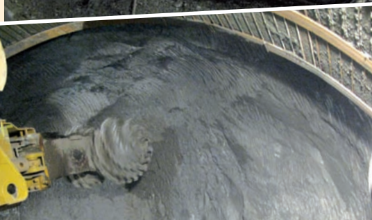
Tunnel du Graitery : excavation par minage au moyen d'un « Jumbo » dans les calcaires et d'une haveuse dans les marnes
