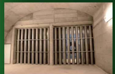
6 Tunnel du Raimeux, centrale de ventilation
