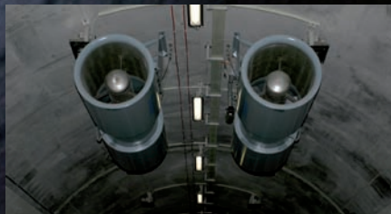
Ventilateurs de jet
