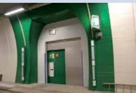
Tunnel du Raimeux: tous les 300 mètres, une issue donne accès à la galerie de secours.
