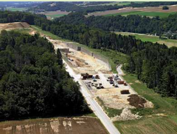
Terrassements au portail Est du tunnel du Bois de Montaigne, au Sud de Courtedoux.
