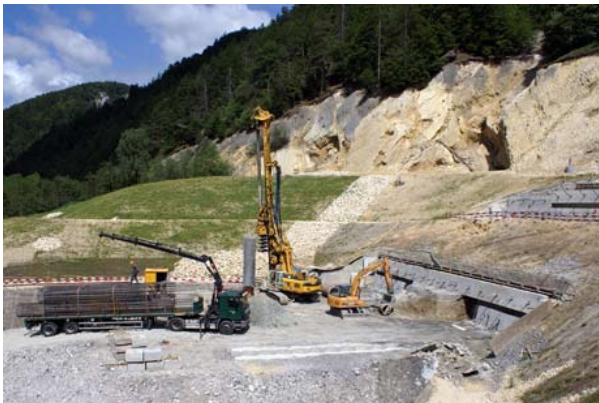
Portail sud: exécution de pieux forés pour stabiliser la zone du portail (28.05.2009).
