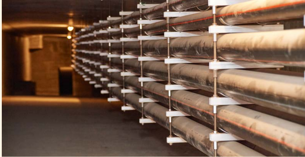
Tuyaux de protection des câbles courants dans les caissons des viaducs.
