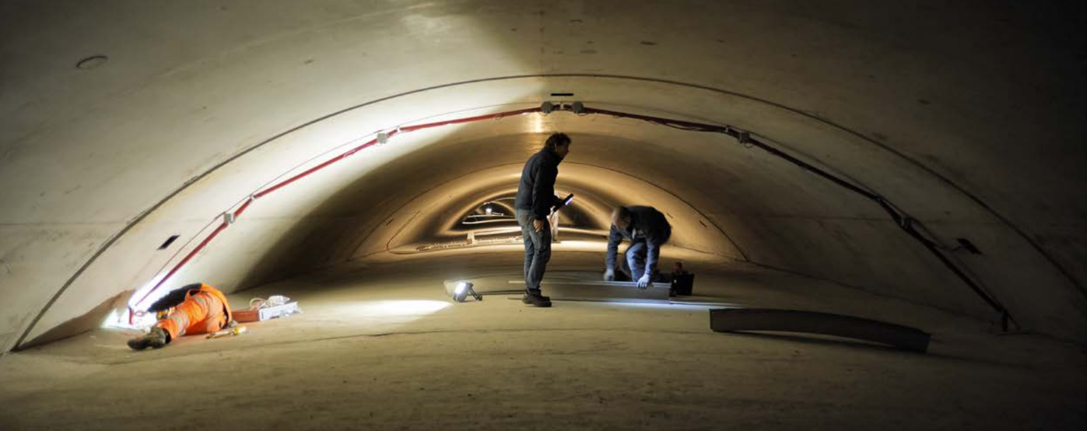
Vue d'ensemble de l'instrumentation posée en calotte au-dessus de la dalle intermédiaire.
