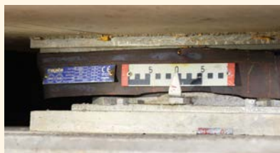
Règlette de mesure des mouvements du tablier des viaducs.
